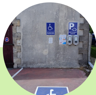
Bornes de recharge électrique et parking 2023
